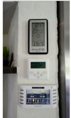
ÖVERVAKAS ELEKTRONISKT. Huset har ett traditionellt elsystem i botten, men där intelligensen är påkopplad som slutsteg. Den mäter energin, ser och styr allt, såsom temperaturen i vattentanken, ventilationsanläggningen, ljusprogrameringen och motorvärmarna på vintern.
